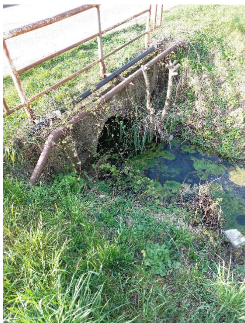
Příloha č. 14, zanesený potok – ulice Lesní u č.p. 132
