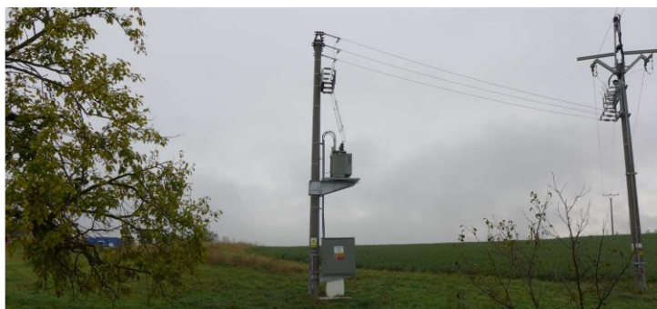
Stávající trafostanice T8
